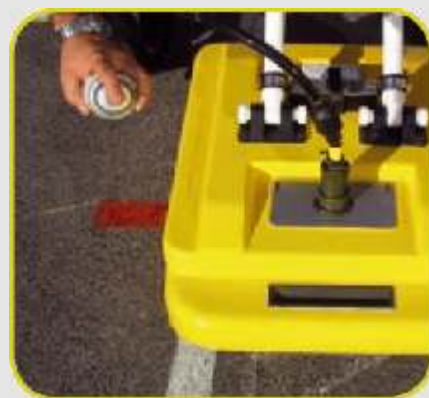
Instalacje podziemne mogą być zaznaczone bezpiecznie na polu robót
